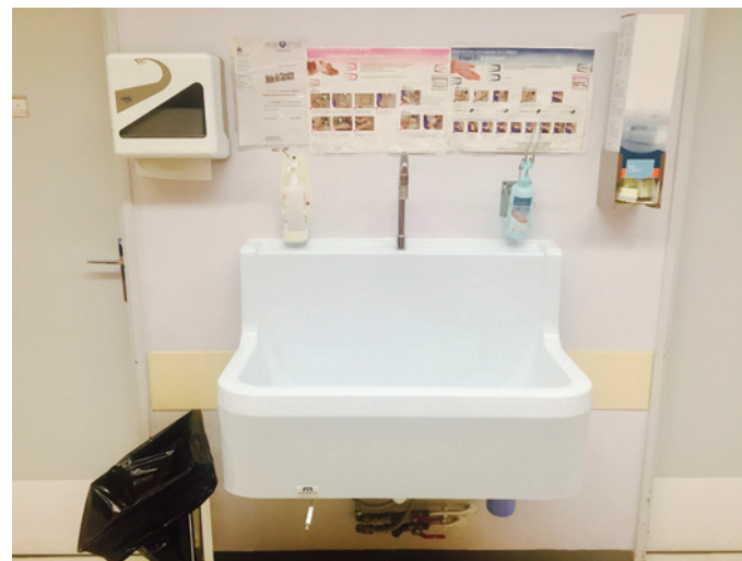
Figure 11. Auge chirurgicale pour lavage des mains. Les eaux filtrées sont distribuées au chirurgien à l'aide d'un robinet à commande à distance (évitant tout contact). Le savon doux, les brosses de lavage, le papier d'essuyage, la solution hydroalcoolique, sont disposés pour une utilisation facilitée. Une poubelle sur roulettes accueillant les papiers et la brosse de lavage est également disponible. Les notices de rappel du protocole de lavage sont également affichées.
